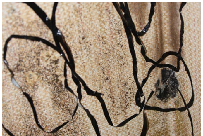
intervention graphique en scotch Chatterton. Révéler les fissures, écailllements et moisissures de murs insalubres.
